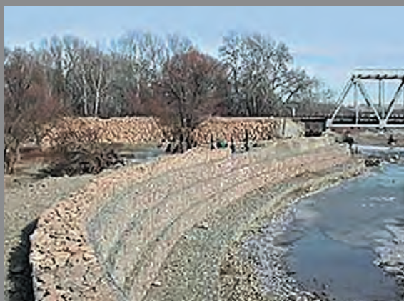
Восстановительные и берегоукрепительные работы на 27 км перегона Ураковская - Эркен - Шахар Северо-Кавказской ЖД. Россия.
