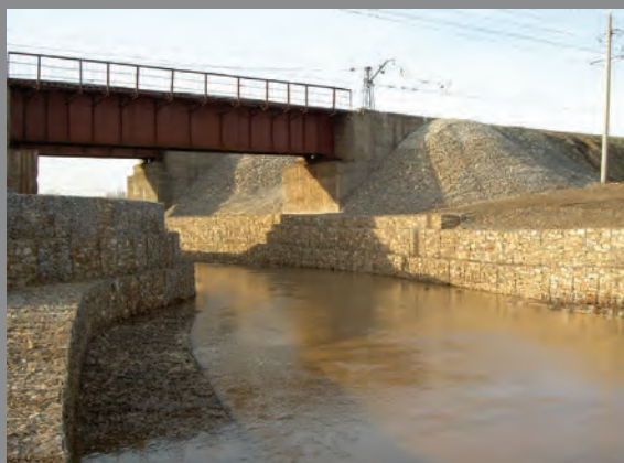
Железнодорожный мост через р. Белекес, защита опор ЖД моста. Башкортостан, Россия.
